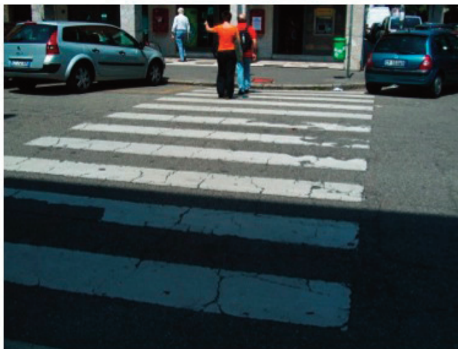
prima degli interventi
